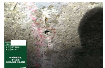
遊離石灰奥のひび割れを捉える
